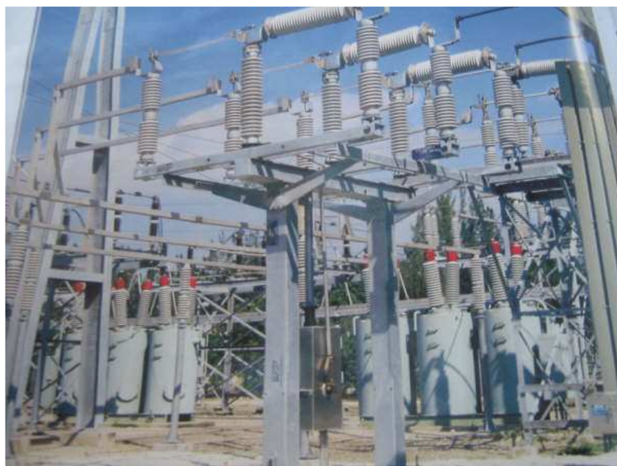
Sub-estación Juticalpa 69 KV
