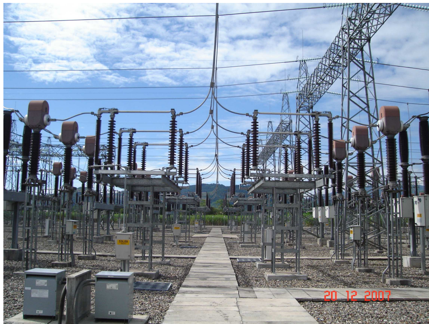
Sub-estación San Pedro Sula Sur 138 KV.
